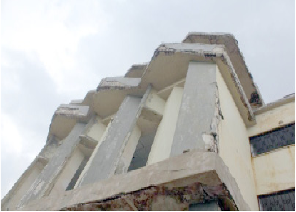
(d) صورة توضح تشققات وتصدع الخرسانة لبعض عناصر المبنى المطلة على الواجهة البحرية
