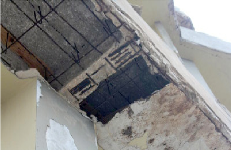
(e) صورة توضح انهيار بلاطة خرسانية وكمرات إحدى شرفات المبنى وتدهور وتلف صلب التسليح
