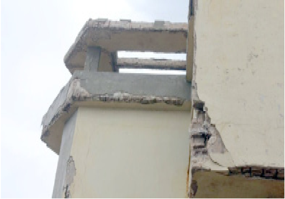
(f) صورة توضح تشققات وتدهور حوائط المبنى - وسقوط الغطاء الخرساني وتآكل صلب التسليح بالكمرات الخارجية
