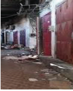
بعد احداث (2019م)
